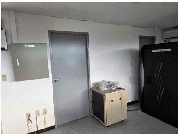
손상내용 전력 배전반 및 전기설비 상태양호 손상원인 -
