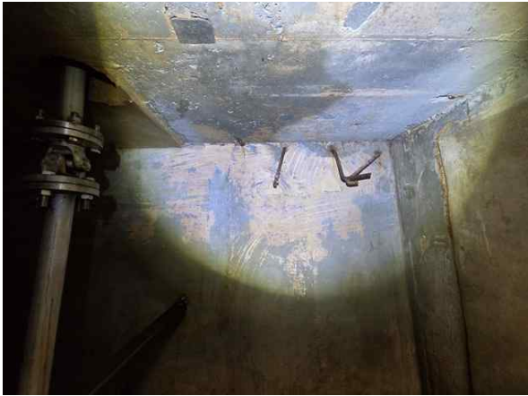
손상내용 유출밸브실 2지 벽체 잡철물 손상원인 피복두께 부족
