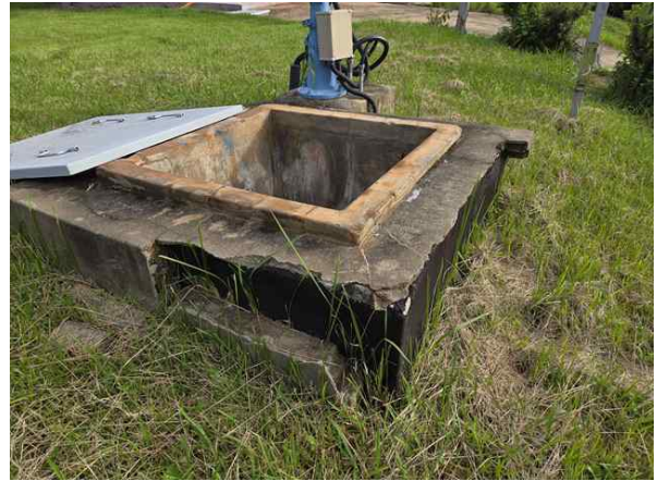
손상내용 유출밸브실 2지 입구 파손 손상원인 외부충격 및 다짐미흡
