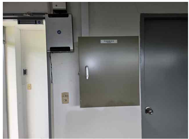
손상내용 전기실 작업용분전반 상태양호 손상원인 -
