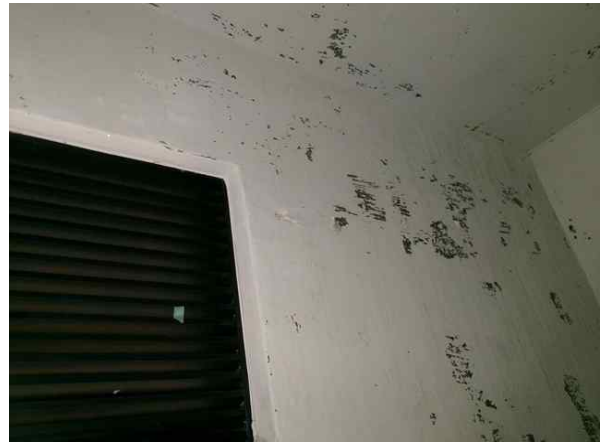
손상내용 계단실 내부 전면 박리(모르타르) 손상원인 공용기간 증가, 노후화
