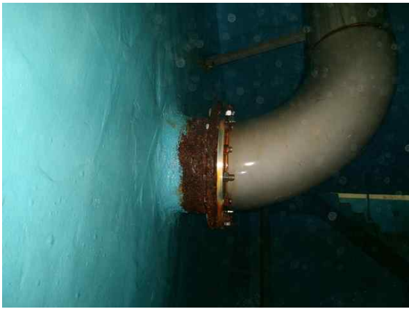
손상내용 1지 유입배관, 볼트류 부식 손상원인 온도차에 따른 습기흡착 등
