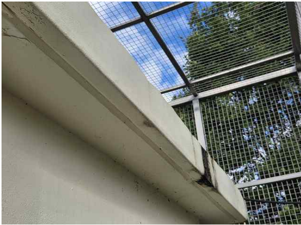
손상내용 계단실 외부 상부슬래브 파손 손상원인 외부충격 및 시공미흡
