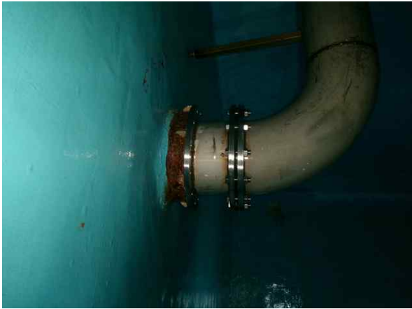
손상내용 2지 유입배관, 볼트류 부식 손상원인 온도차에 따른 습기흡착 등
