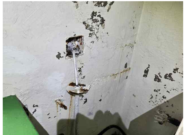
손상내용 계단실 내부 후면 철근노출 손상원인 피복두께 부족
