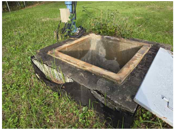
손상내용 유출밸브실 1지 입구 도장박리 손상원인 피복두께 부족
