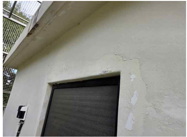
손상내용 계단실 외부 측면 도장박리 손상원인 공용기간 증가, 열화
