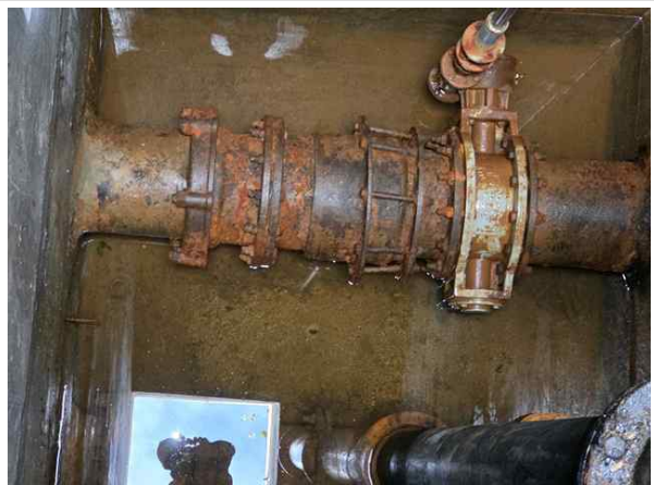
손상내용 유출밸브실 1지 하부슬래브 체수 손상원인 외부 우수유입
