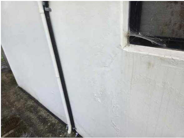
손상내용 계단실 외부 측면 균열 손상원인 건조수축, 온도변화
