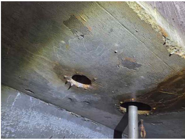
손상내용 유입밸브실 1지 상부슬래브 백태 손상원인 온도차이로 인한 습기흡착
