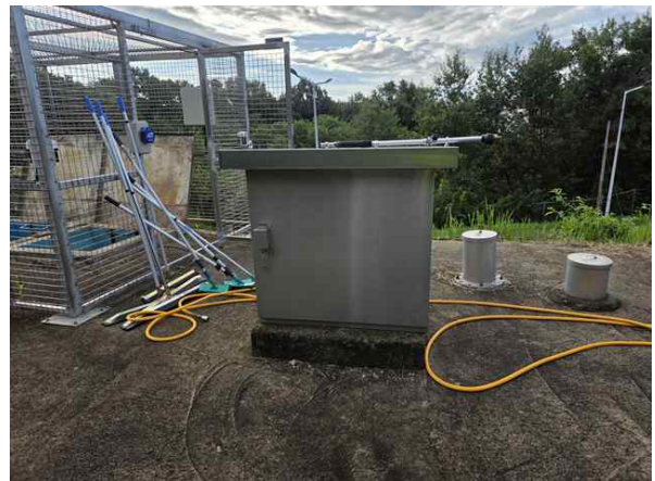
손상내용 외부 현장제어반 상태양호 손상원인 -
